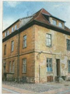
Das alte Holgericht in der Domstraße ist ein herausragendes Denkmal der Schwedenzeit und in sehr schlechtem Zustand.
